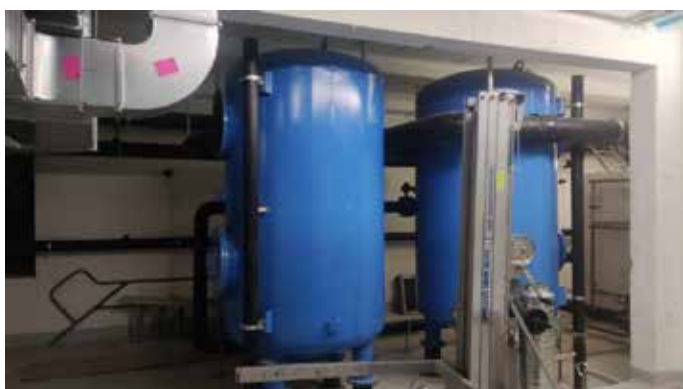
Filter, Wasserleitungen und Lüftung in der Technik
